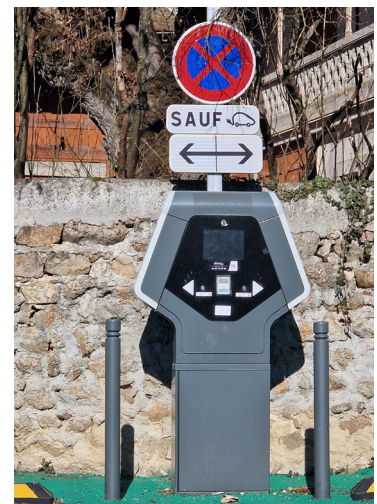
Borne de recharge installée place des moulettes
